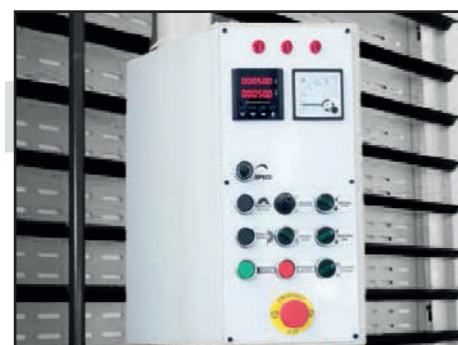
Unidad de control
